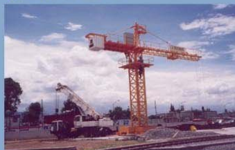
MALACATE de 5 toneladas de capacidad ubicado en una grúa torre para el manejo de durmientes en un taller de mantenimiento del metro (Cd. México)
